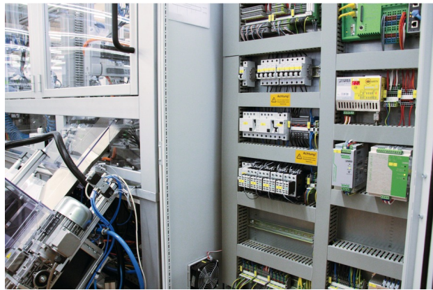
Fuentes de alimentación QUINT POWER en el armario de control
