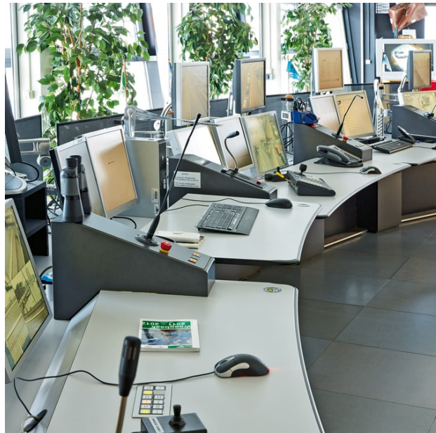
Desde la sala de control se controla el puente levadizo y se supervisa el tráfico marítimo
