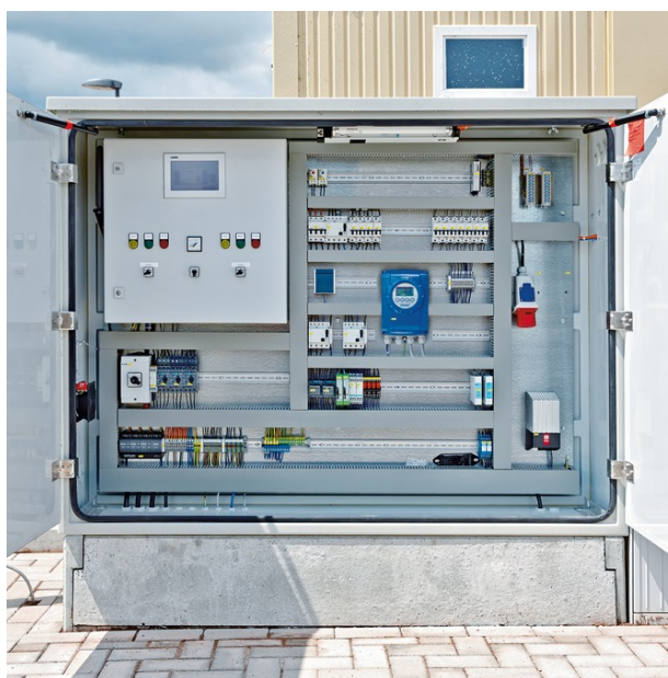
Ovládání dotykovým panelem na místě
