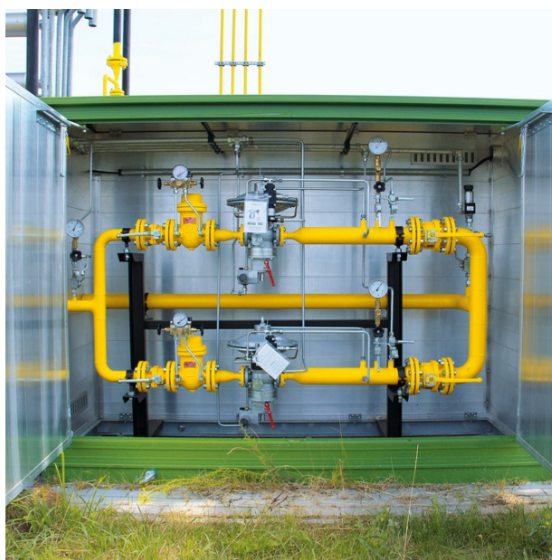
Měřicí stanice pro vyvolání a přenos hodnot průtoku, teploty a tlaku
