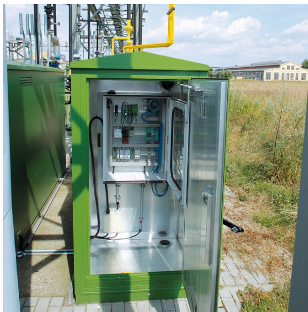
Rozváděč s malou řídicí jednotkou a seřazenými moduly Inline
