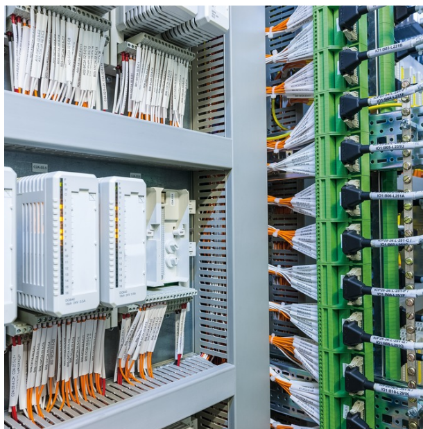
Styresystemskap med VIP-overgangsmoduler og pålagte systemkabler
