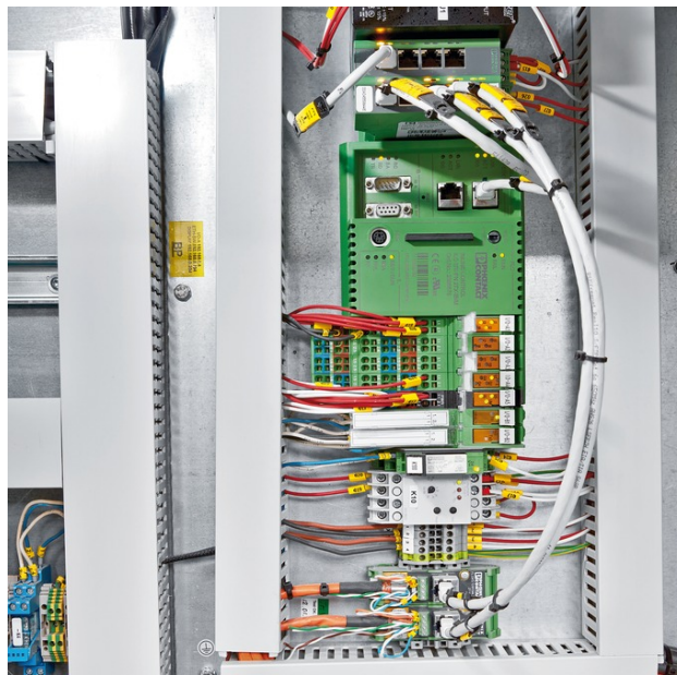
Der ILC 370 PN/M steuert sämtliche auf der Fähre installierten Systeme über das Profinet-Protokoll
