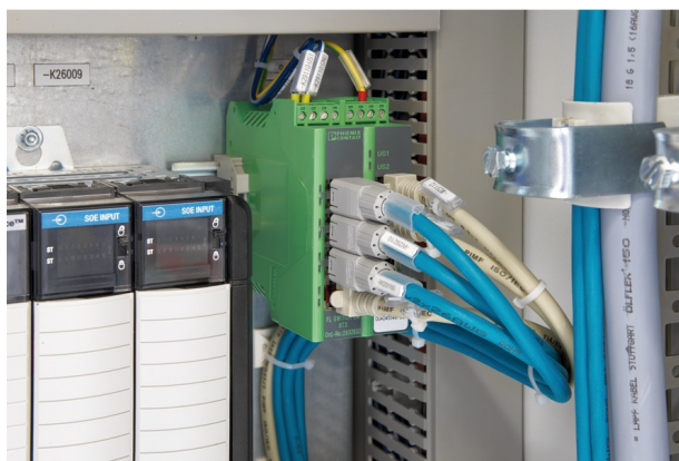
Utilisation de switches Lean administrables
