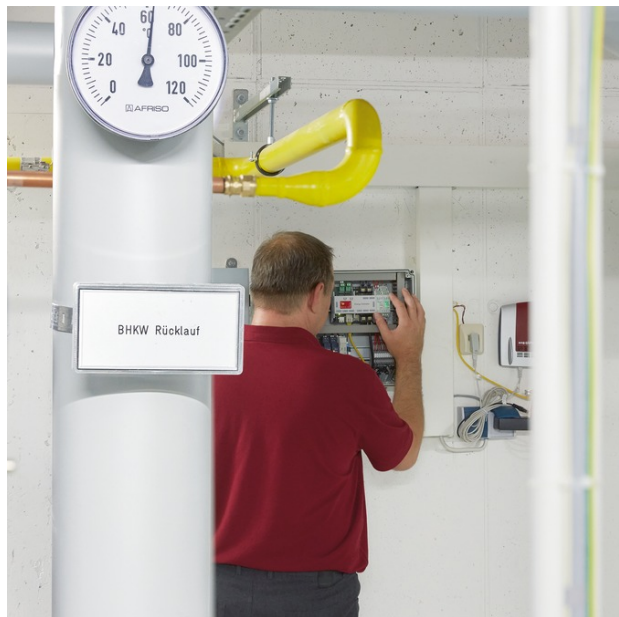
BHKW-Zugriff über das Internet – die Messdaten bleiben im Energiemanager
