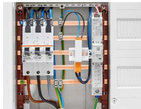
Einspeisung über den SH-Schalter und Spannungsabgriff über eine Sicherungsbox.
