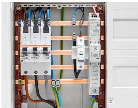
Einspeisung über den SH-Schalter und Spannungsabgriff über einen Leitungsschutzschalter.
