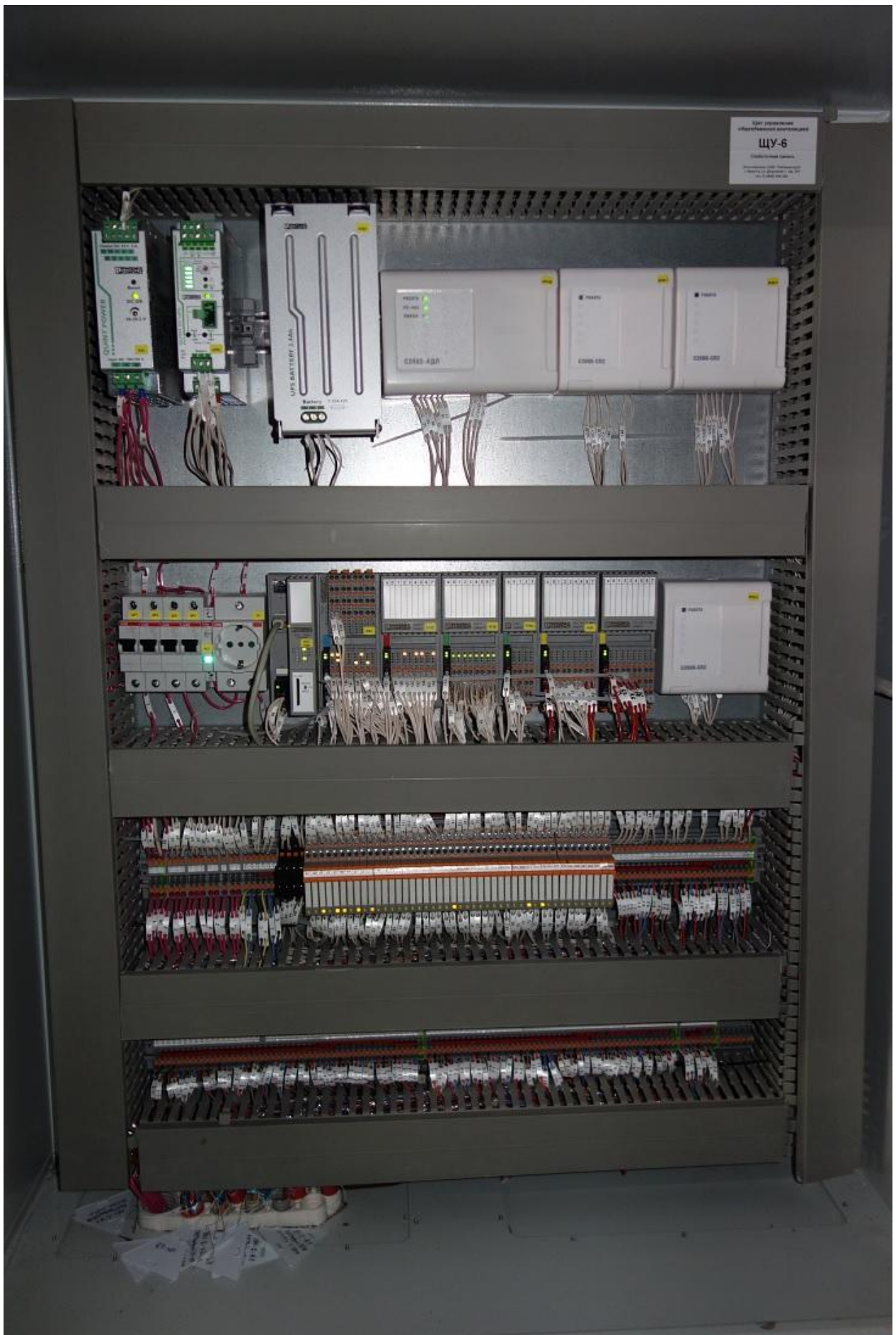
Рис. 4. Внешний вид открытого шкафа управления.
